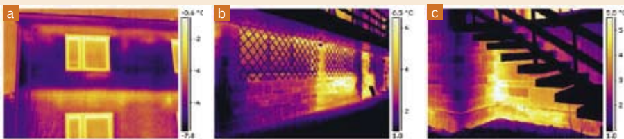
Obrazy termowizyjne ścian zewnętrznych budynku. Pomarańczowo-czerwony pas nad parterem i nad piętrem (a) wskazuje, że wieńiec ma znacznie mniejszą izolacyjność niż reszta ściany, okna w piwnicy nieprawidłowo osadzone (b), a naroże ściany piwnicy niewłaściwie ocieplone (c)
