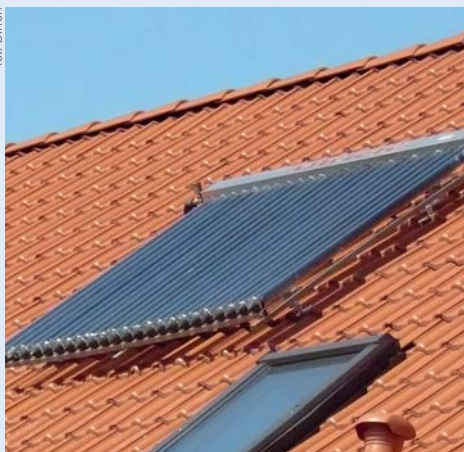
Kolektory słoneczne umieszczone na najbardziej nasłonecznionej, południowej pości dachu mogą być być źródłem znaczących zysków ciepła
